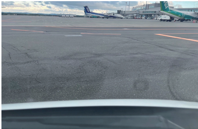
▲悪化したランプエリア内の路面
